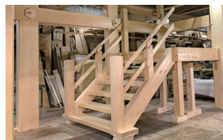
仮組みをし、部材の納まりを確認しながら調整しました。
